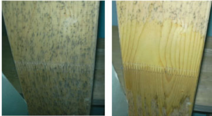
Figure 6.2 Taches de fer (à gauche) et traitement à l'acide oxalique (à droite)
