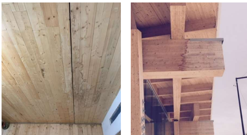
Figure 6.2 Cernes d'eau causés par une lixiviation inégale des extractibles
